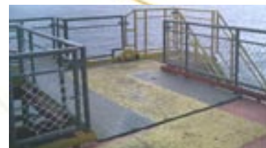
AmpliNett® rekkverksfylling, Statfjord C
